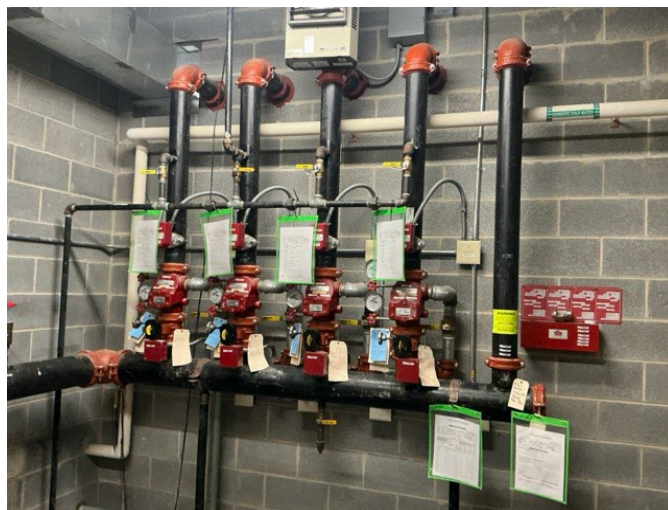
34 - FIRE SPRINKLER RISERS
